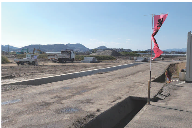
能間工区ですすむ基盤整備事業 ハウス園芸団地が予定されています
